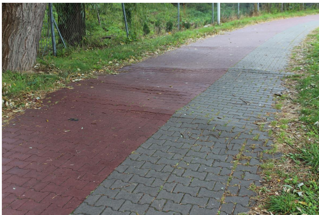
Fot. 67. Nawierzchnia ścieżki wypiętrzona przez korzenie drzew.
