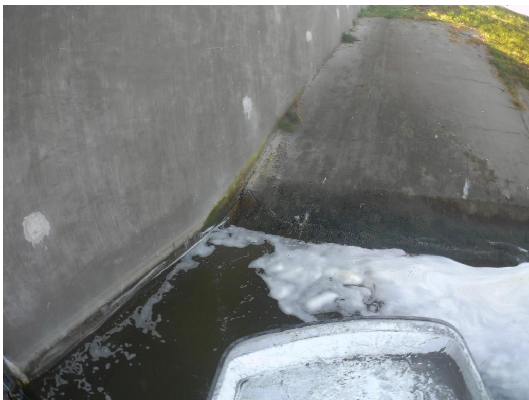
Fot. 25. Wyciek wody na styku lewego przyczółka jazu i płyt betonowych zabezpieczających skarpe dolnego stanowiska.
