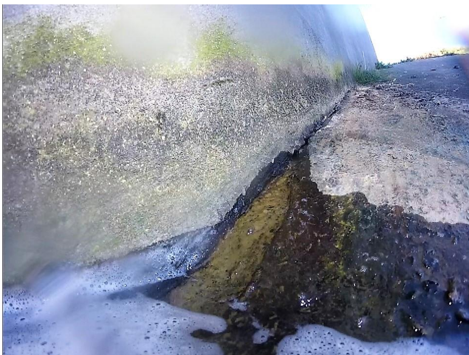
Zdjęcie nr 25. Łączenie ściany zapory z umocnieniem lewego brzegu – wyciek wody.
