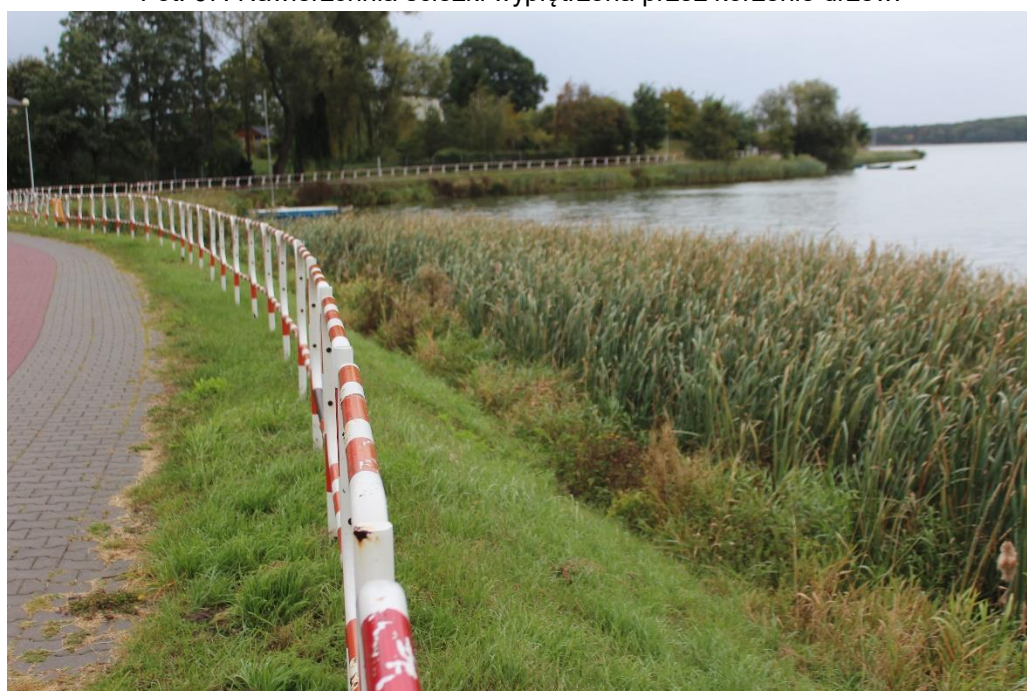
Fot. 68. Skarpa odwodna i korona lewej zapory bocznej.
