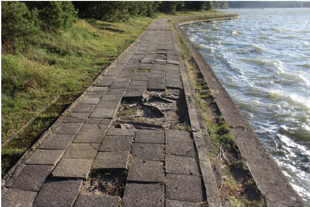
Fot. 42. Uszkodzenie chodnika wzdłuż nabrzeża.
