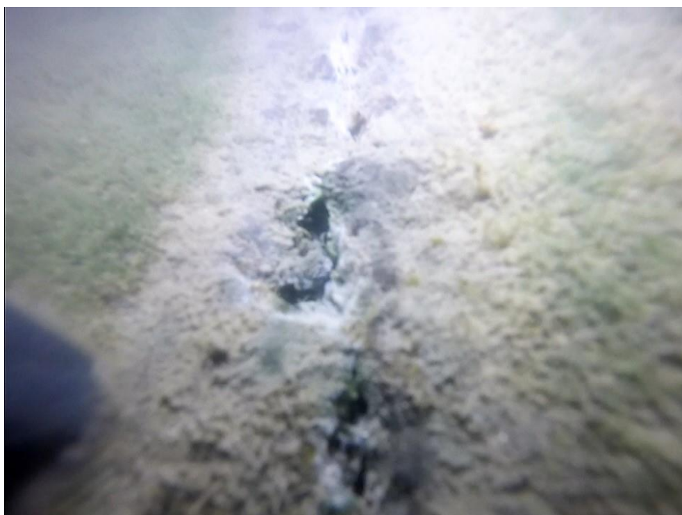
Zdjęcie nr 32. Umocnienie prawego brzegu – wyciek wody.
