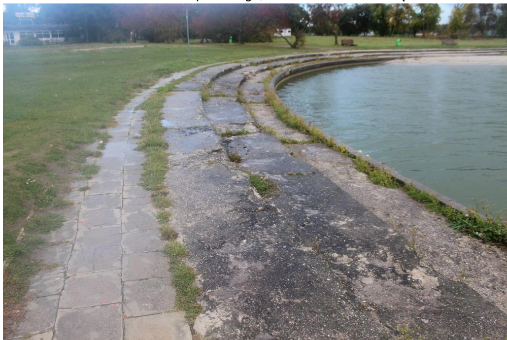
Fot. 60. Powierzchnie betonowe nabrzeża w rejonie plaży przy pomoście nr 1.
