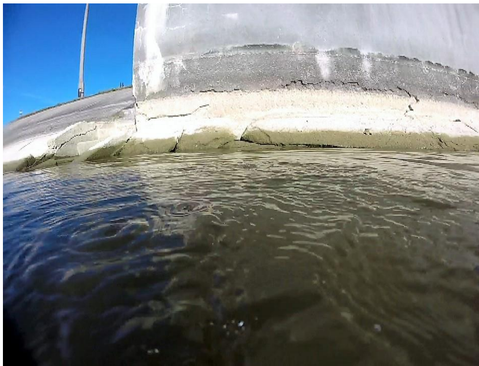
Zdjęcie nr 23. Filar środkowy - lewe przesło jazu – spękany beton.
