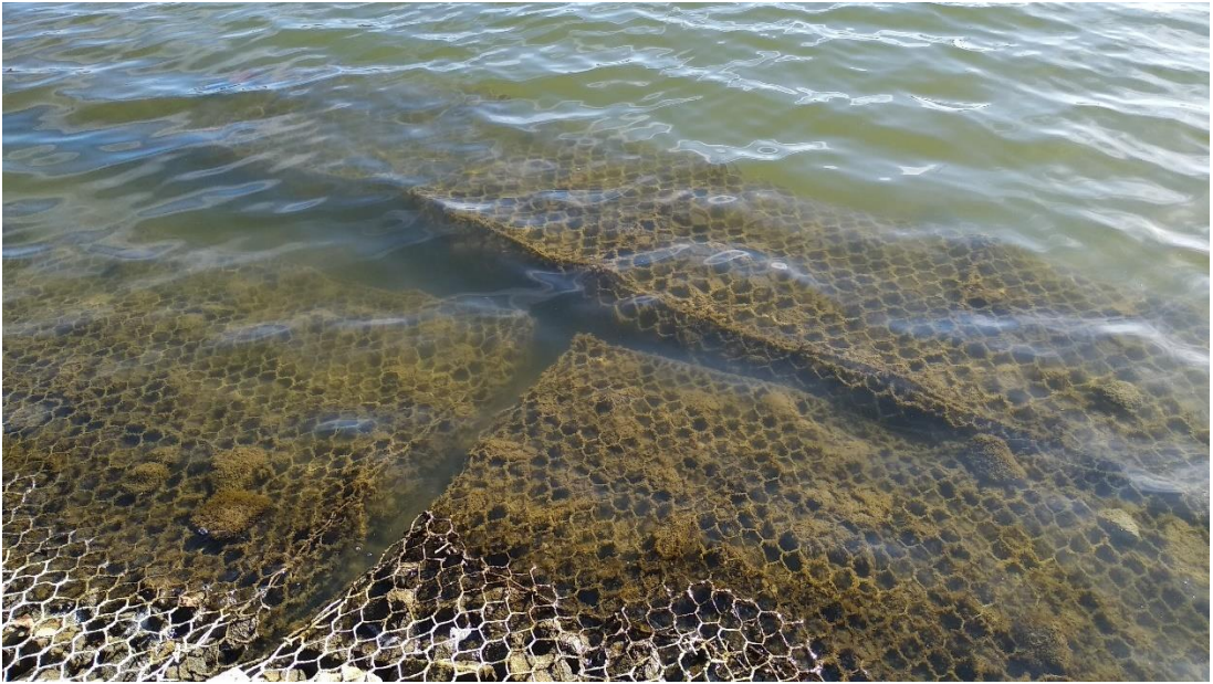
Fot. 7. Wodok osuwających się materace gabionowych - skarpa odwodna prawobrzeżnej zapory.
