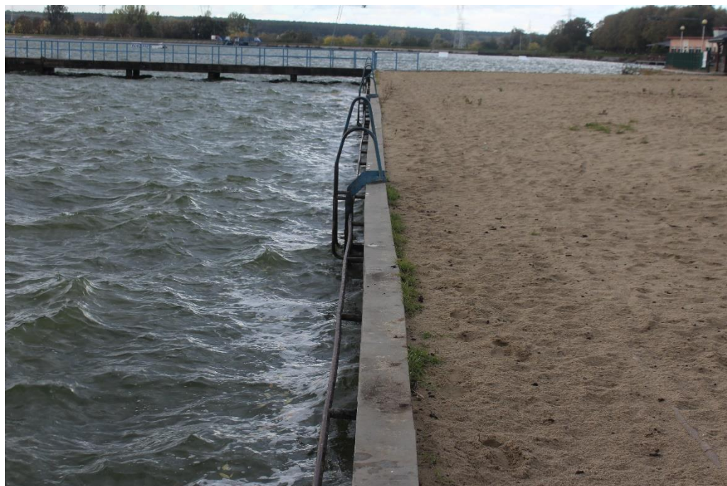
Fot. 35. Nabrzeże pionowe w rejonie pomostu nr 2.
