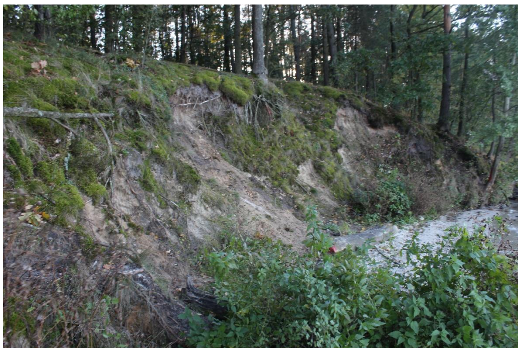
Fot. 47. Wysoki brzeg zalewu, widoczna erozja skarpy.
