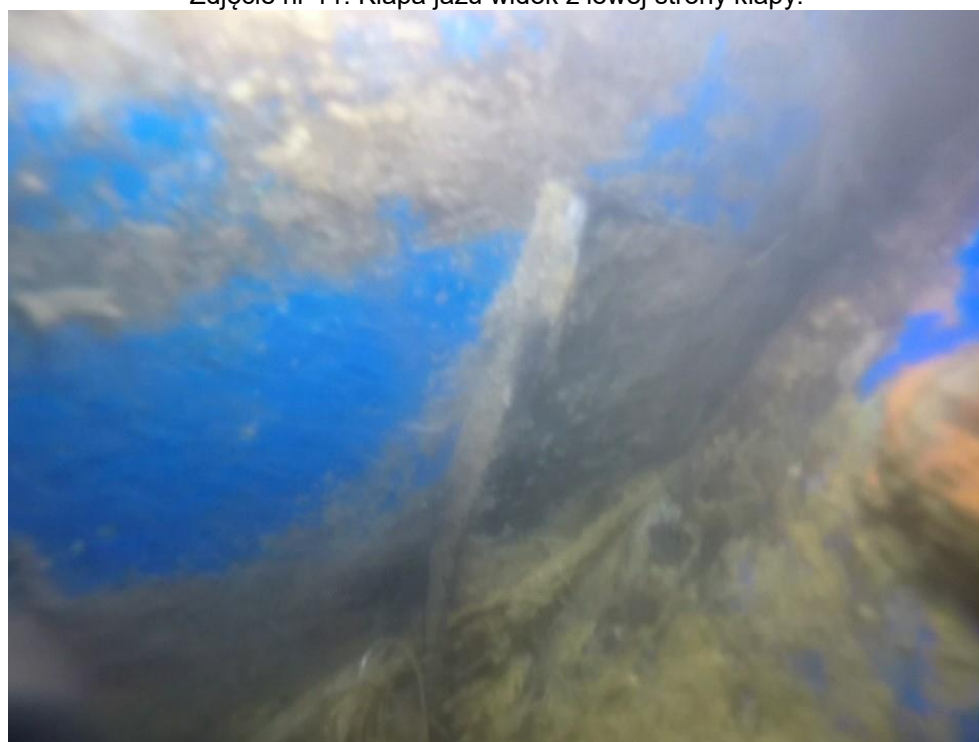
Zdjęcie nr 12. Kłapa jazu widok z lewej strony kłapy.
