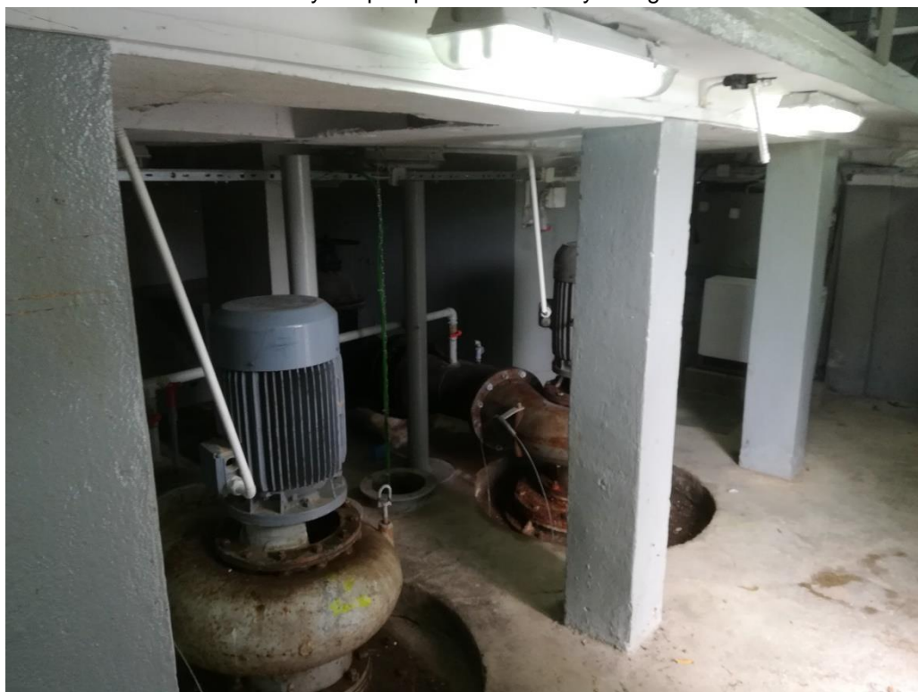
Fot. 84. Pompy w budynku pompowni P-2.
