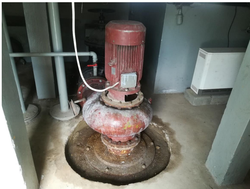
Fot. 81. Pompa w budynku pompowni P-1.
